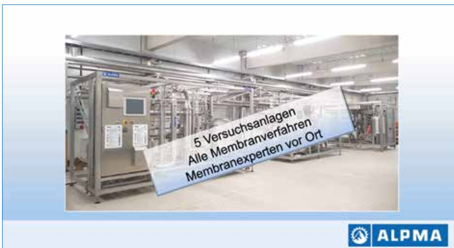
Bild 3: Auslegung der Anlagengröße auf Basis von Versuchen im Technikum Membranfiltration
